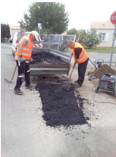
L'ensemble du village a été sillonné pour des réparations de voirie avec de l'enrobé à froid. Ici les nids de poule devant la MAM.
