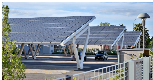
L'ombrière solaire offre aussi la possibilité d'installer des bornes de rechargement pour véhicules électriques
